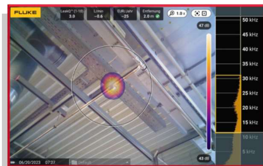
Bild 2: Druckluftleck in einer Rohrleitung an der Decke
